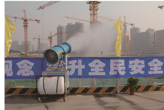
场地固定雾炮设置
