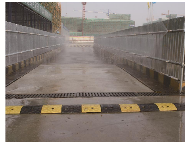
过水池+自动冲洗平台
