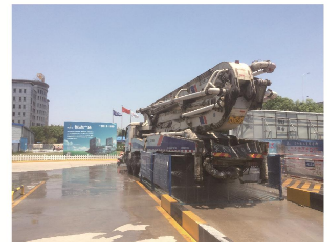
过水池+自动冲洗平台
